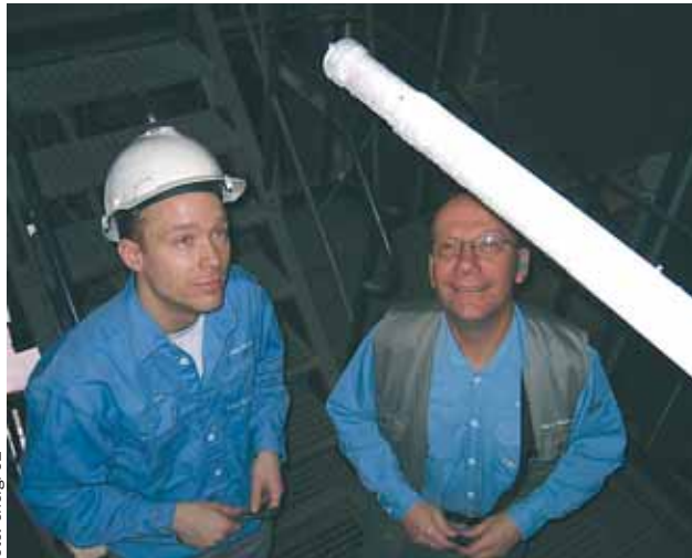
Lasse Tobiasen og Kaj Sørensen fra Energi E2 inspicerer belægningssonden på kraftvarmeværket i Slagelse.
