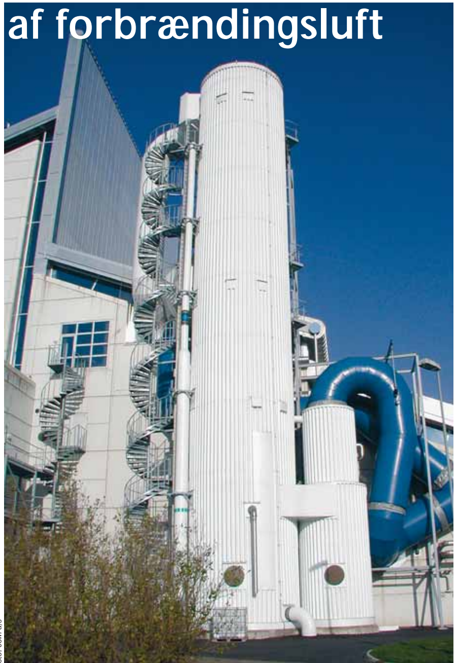
Skrubbetårn til afkøling af røggas og opfugtning af forbrændingsluft på det træfyrede Allöværk i Kristianstad.
