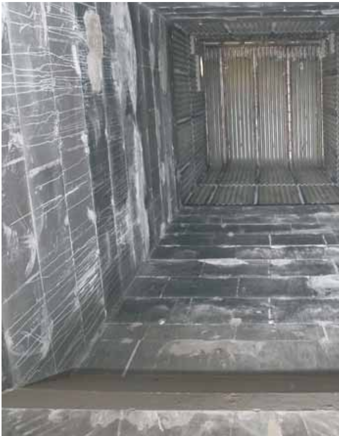
Et kig op i en affaldskedel på Haderslev Kraftvarmeværk, der har fået ny belægning i en flot håndværksmæssig udførelse.
