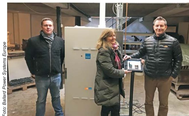
Installation af et SIMBA-anlæg på Gasmuseet i Hobro.
