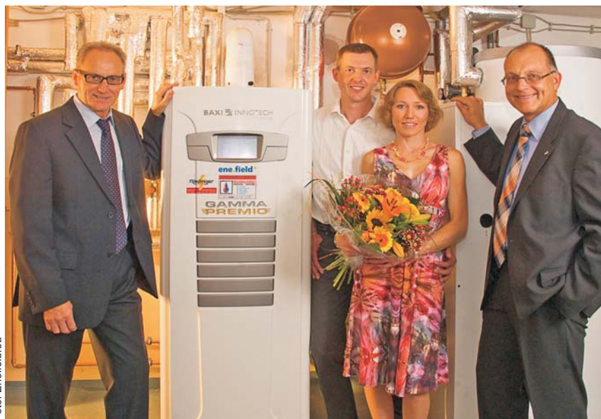
Det første af i alt 1.000 mikrokraftvarmeanlæg i Enefield-projektet blev i efteråret 2013 installeret hos familien Bossler i Homburg, nord for Frankfurt. Anlægget blev leveret af BAXI INNOTECH, der er en af de ni producenter, som er tilknyttet projektet.
