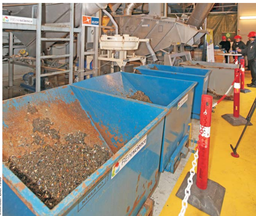
REnescience-anlægget hos Amager Resourcecenter.
