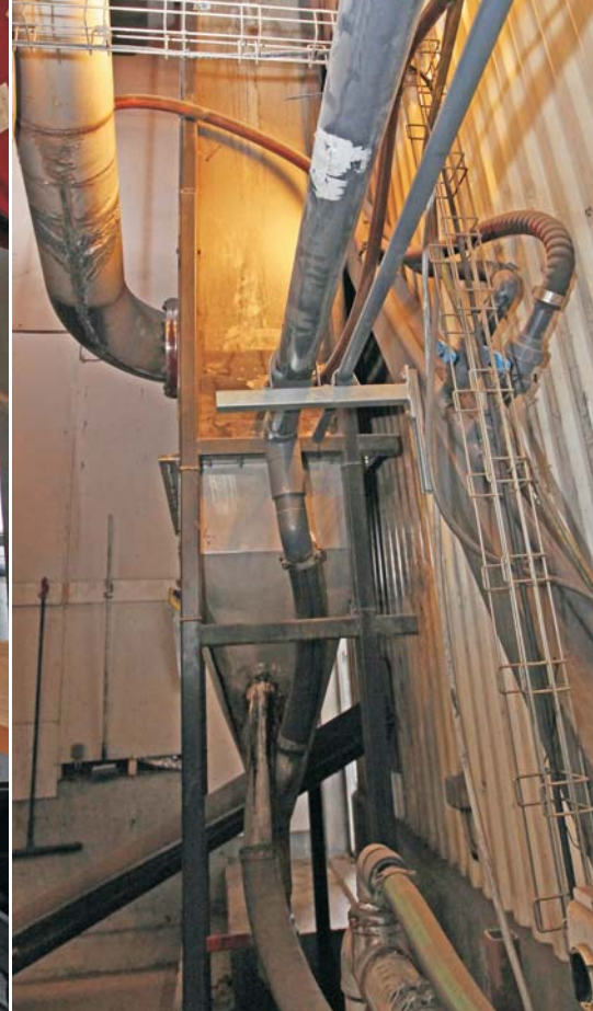
Scrubberen til anlægget i Gjøl.
