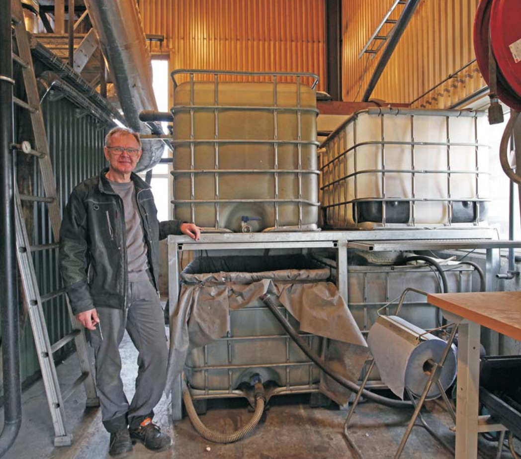
Driftsleder Arne Nielsen ved de kar, der rens vandet fra scrubberen i Gjøl.
