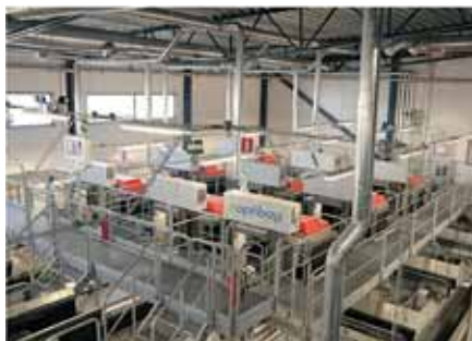
Det nye optiske sorteringsanlæg hos Tekniska Verken i Linköping.
